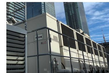
屋上の省エネ設備
